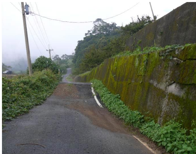
圖 7 根據室內判釋結果，實際赴現場找尋可能的地形特徵證據，此為圖 6(A)處於現地上出現崩崖切過路面，呈現明顯的落差與擋土牆破壞的情況
