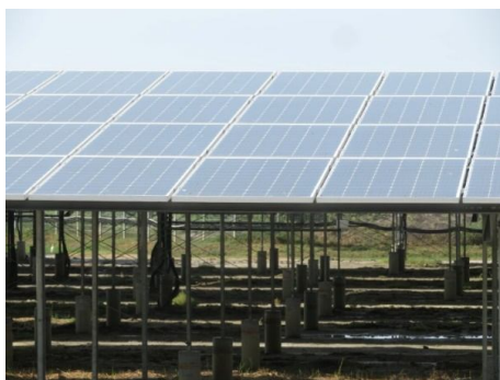
圖 7 八區鹽田地面式太陽能板設置情形
