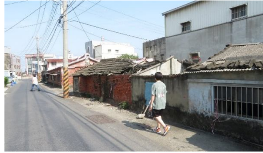
圖 13 遭遇地層下陷的老舊房舍
