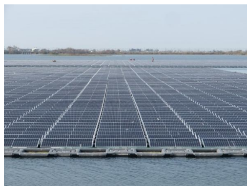
圖 9 九區鹽田水域-浮動式太陽能板設置情形
